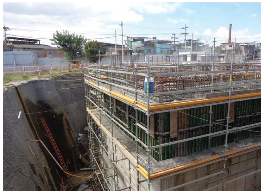
Figura 6.12 – Saneamento da AP5 - ETE Deodoro
